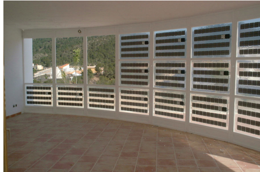
(b) Sistema conectado a red instalado como acristalamiento de un edificio.
